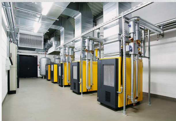
Sala compressori con recupero del calore.
