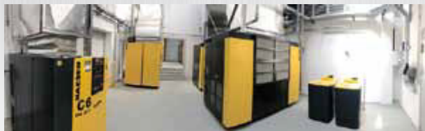
Fig.4 - Vista parziale sala compressori.
