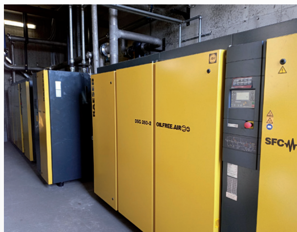
La sala compressori.
