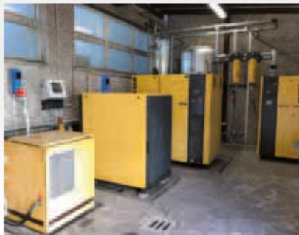
L'attuale sala compressori di Pianoro.
