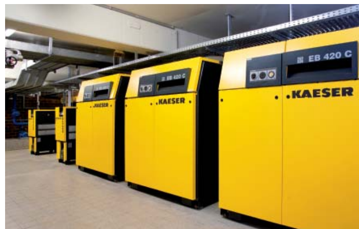
Presso l'acquedotto di Jägersburg dell'associazione per l'approvvigionamento idrico Riedgruppe Ost, le soffianti rotative a lobi KAESER, coordinate e gestite dalla centrale di controllo, garantiscono un sicuro ed efficiente controlavaggio nel processo di filtrazione a sabbia.
