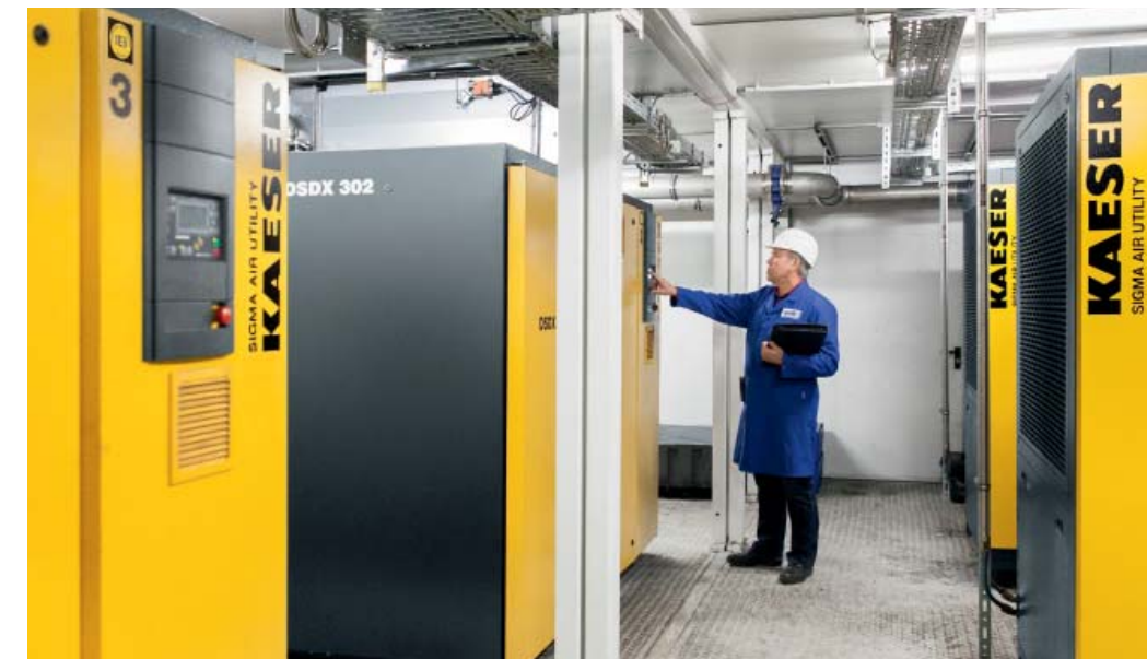
Soluzione salvaspazio: stazione KAESER in container
